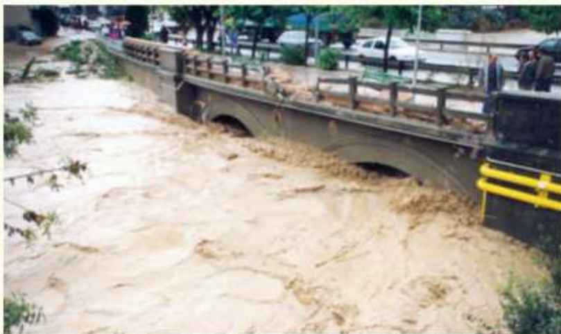
Pont del Foix del Monjos a punt de col·lapsar, a la rierada 1994.
